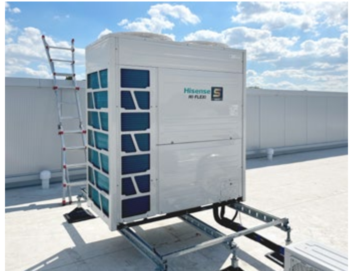
Die auf dem Gebäudedach installierte Außeneinheit
