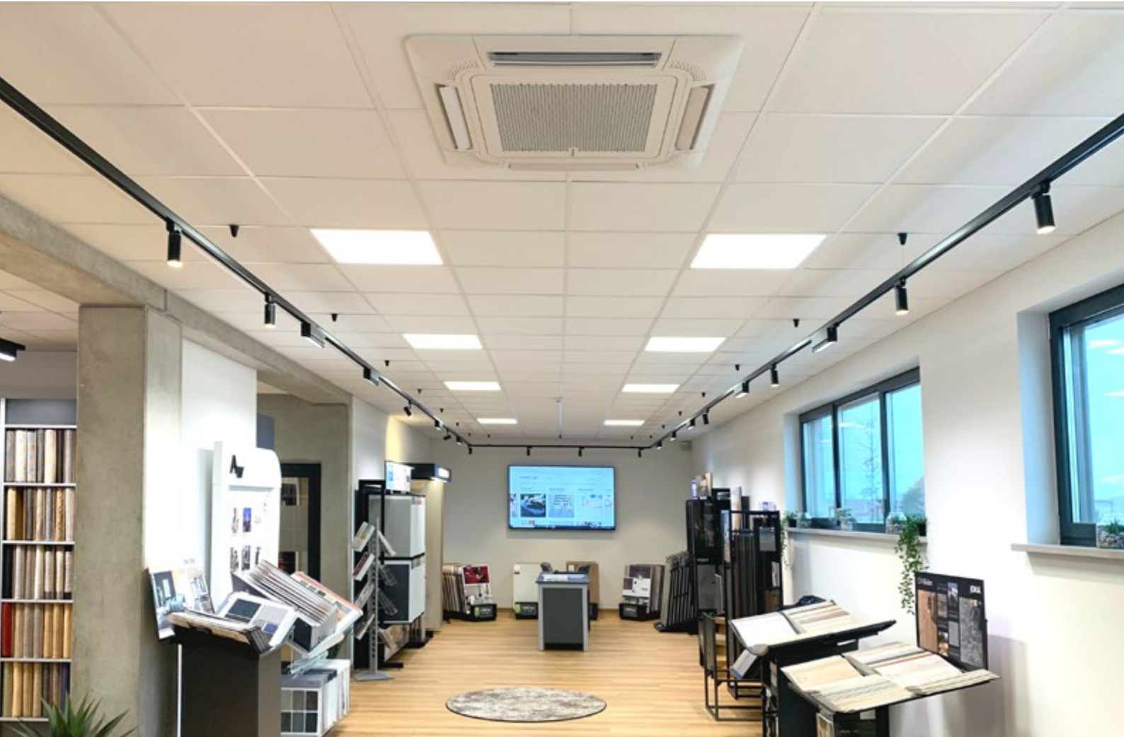
HEVO-Teppichscheune mit Hisense Luft/Luft-Wärmepumpen klimatisiert. Seite 14
