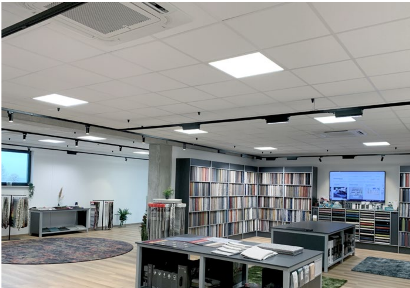
Hisense Kassettengeräte im Showroom der Teppichscheune
