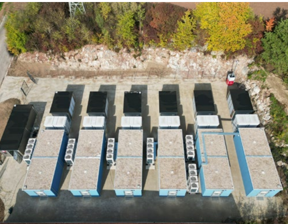
VRF-Außeneinheiten von Panasonic zur Klimatisierung der Batteriespeicheranlage
