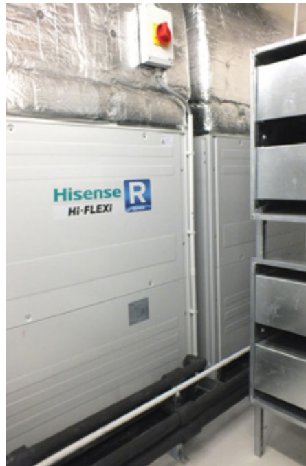
Hisense VRF-Außeneinheiten mit Kanalanschluss im Brandschutzbereich F90
