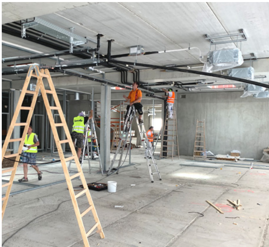
Installation der Kassettengeräte im Eurorastermaß
