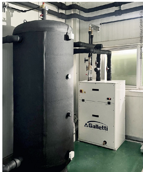
Wassergekühlter Galletti-Kälteerzeuger mit interner Primärpumpe und einem 1.000 Liter Pufferspeicher mit diffusionsdichter Isolierung
