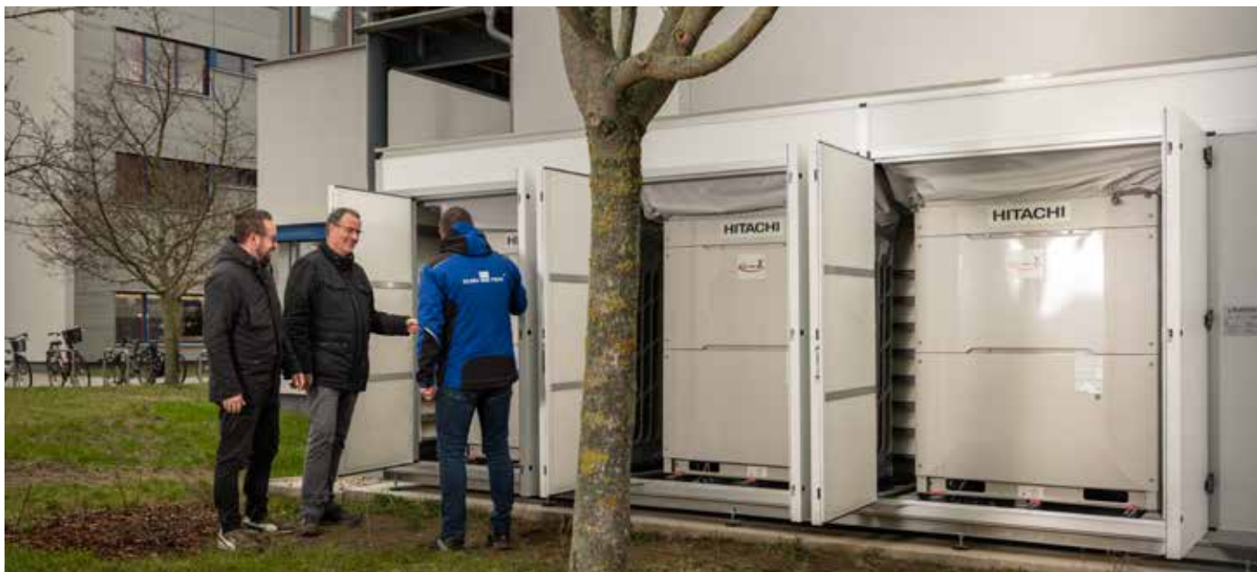
SetFree VRF-Außeneinheiten mit individueller Schallschutzumhausung, v. l. Matthias Hofmann (Hans Kaut GmbH), Vertretung des Bauherrn, Siegmart Gottschalch (CLIMATECH Montage GmbH)
