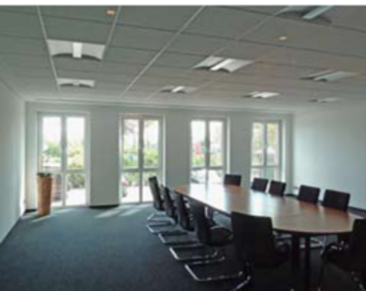
Bild 4: Besprechungsräume mit Zwischendeckengeräten, unsichtbar und extrem leise
